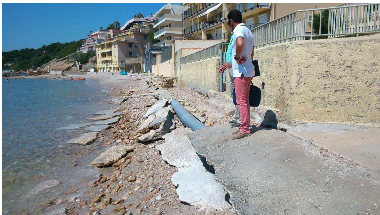
3 Protection endommagée depuis le regard n°3 (2016)
