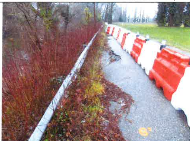
3 - Effondrement du chemin
