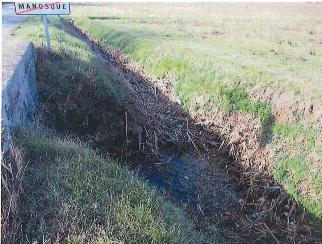
Figure 6 - Photographie n°5: Canaux d'irrigation utilisés pour la gestion des eaux pluviales
