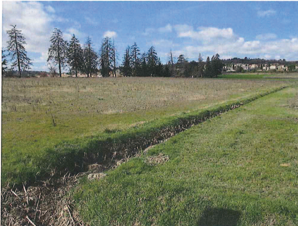
Figure 5 - Photographie n°4: Canaux d'irrigation utilisés pour la gestion des eaux pluviales
