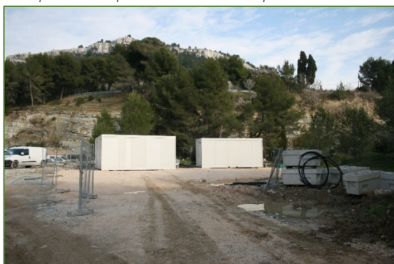
Empiètement par le chantier de la parcelle voisine
