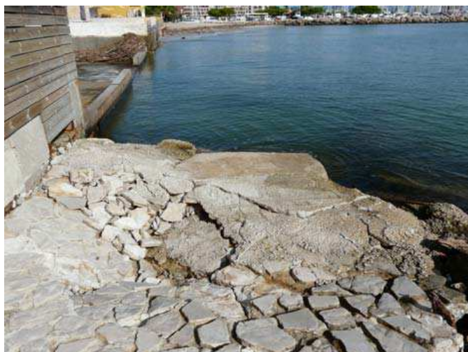
Figure 11 : Détérioration du chemin existant
