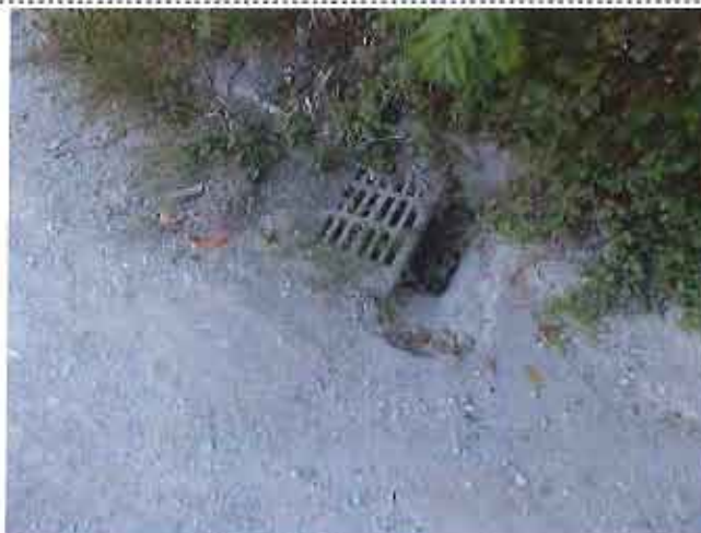
Figure 10 : Collecteur des eaux de voiries au croisement du vallon sec et du chemin des Bastides des Tourelles
