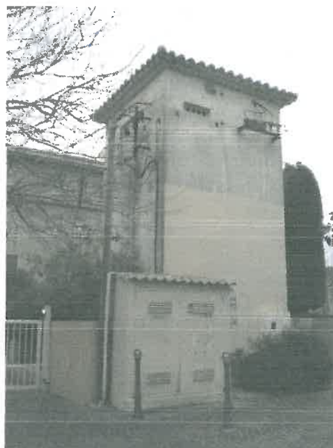
Transformateur (zone de projet aval)
