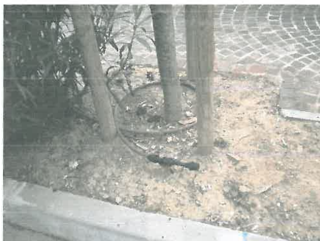
Réseau d'arrosage (zone de projet aval)
