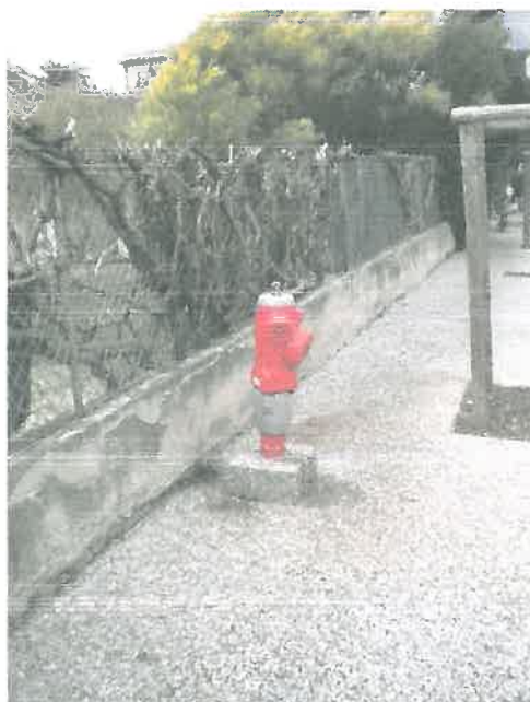
Borne incendie (zone de projet aval)
