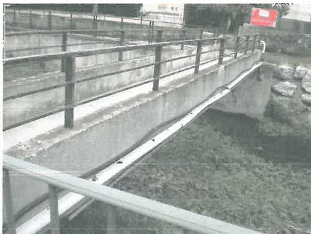
Fourreaux de réseaux non déterminés (zone de projet amont) – source : Ingérop Conseil & Ingénierie
