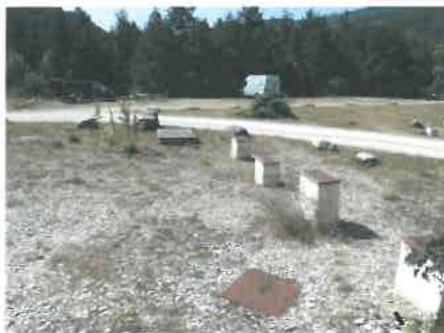
Station d'épuration du camping - Traitement
