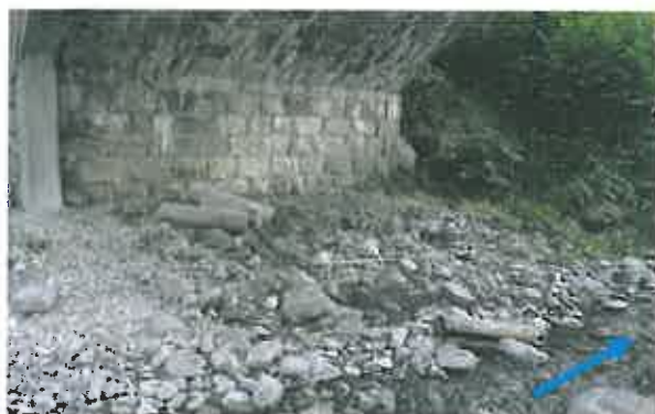
3 - Légère érosion d'un banc en pied de voûte gauche
