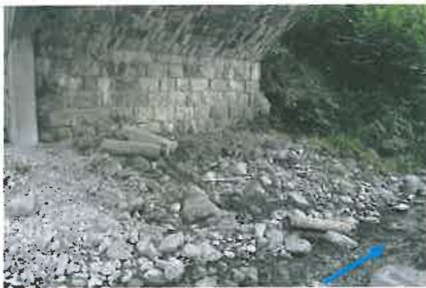
3 - Légère érosion d'un banc en pied de voûte gauche
