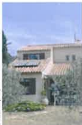
Photovoltaïque solaire pour chauffage et eau chaude
