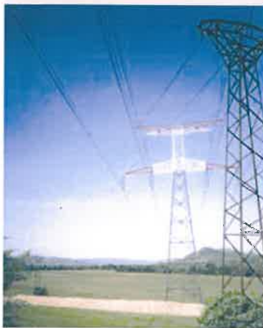
Transport de l'électricité par le réseau de lignes haute tension
