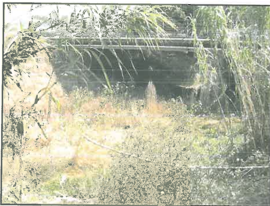
Pont situé à 250m au Nord de la RD14 sous lequel coule la rivière de la Garde
