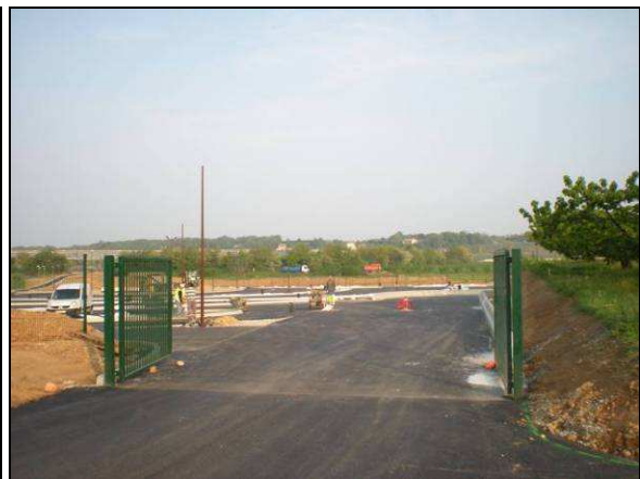
Portail lourd d'accès au parc permettant la fermeture du parc la nuit
