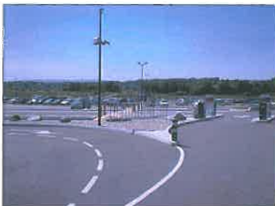
Caméras et mâts d'éclairage (respectant les normes et niveaux de luminosité)
