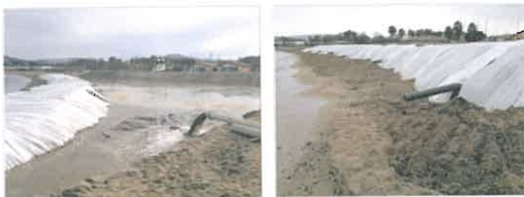
Figure 2 : Bassin d'égouttage des sables dragués (Marines de Cogolin)
