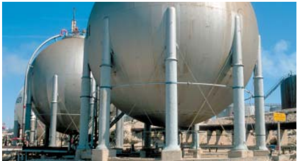
Ancrage des sphères de stockage au sol – BP Lavéra [Photo R. Lengereau]
