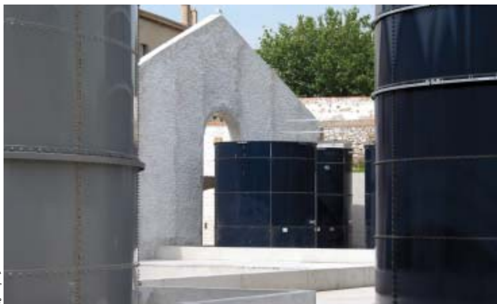
Bacs de traitement - LEGRE MANTE - Marseille
