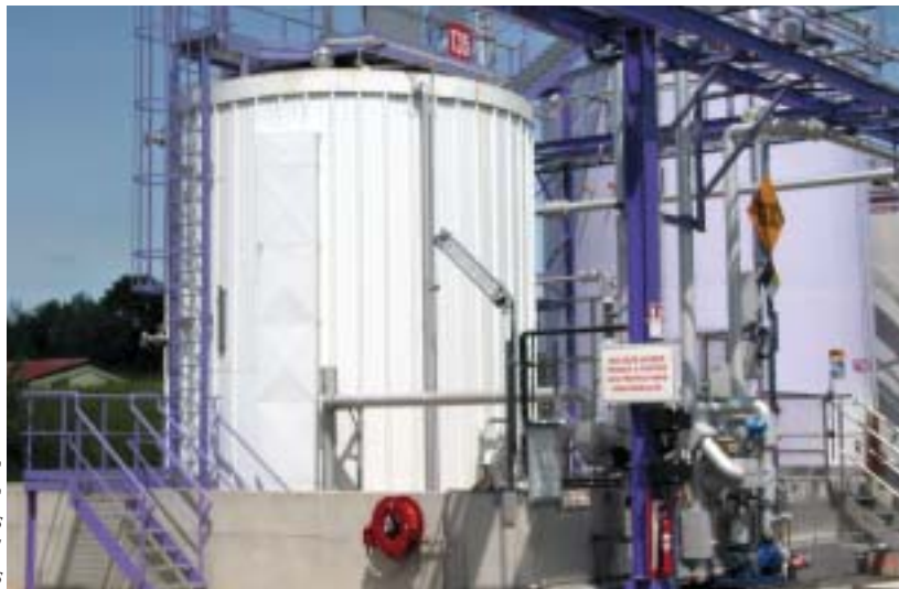
Cuves de stockage refroidies - SNPE - Sorgues
