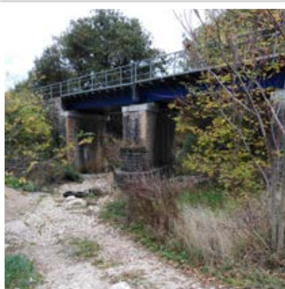
Passage de la voie ferrée sur un pont au niveau du torrent de St Marcel © LPO PACA
