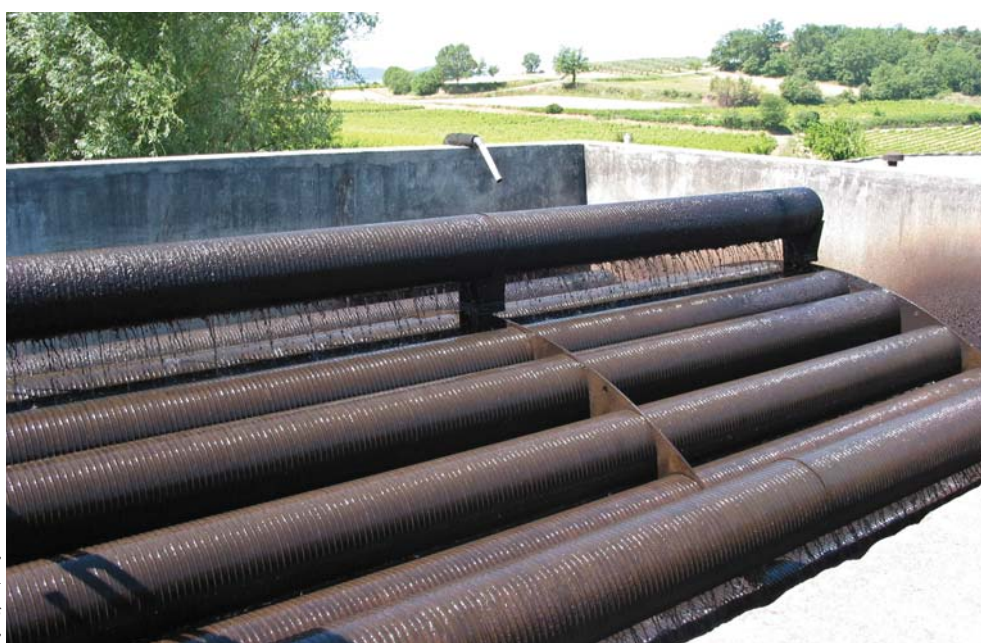
Filtre à rouleaux d'une station de traitement des eaux à Puyméras dans le Vaucluse
