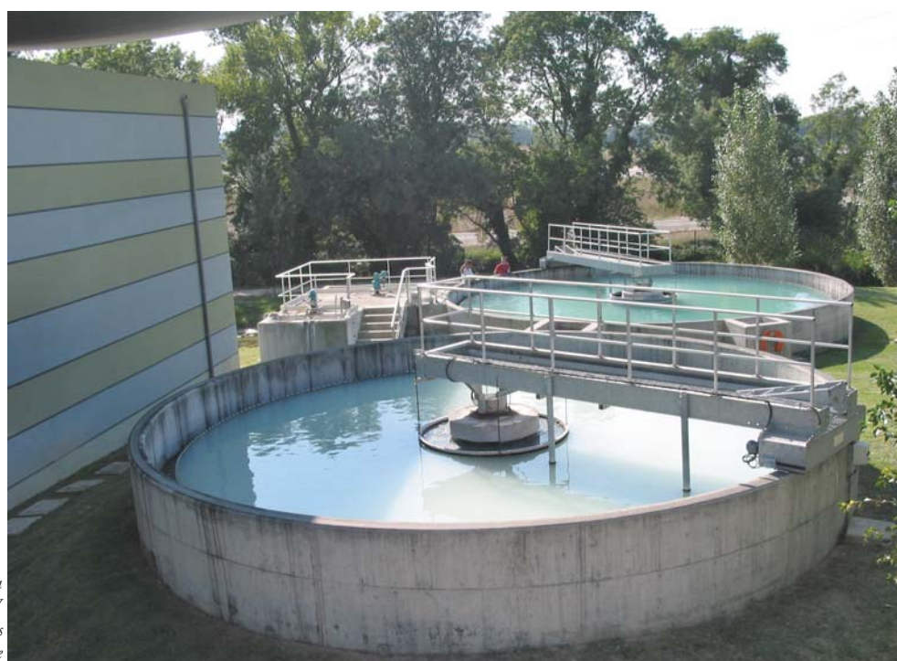
Basin de décantation de la station d'épuration d'OTV à Rousset-sur-Arc dans les Bouches-du-Rhône
