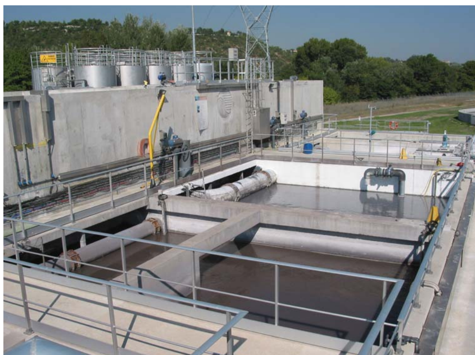
Station d'épuration de la société OTV à Rousset-sur-Arc dans les Bouches-du-Rhône
