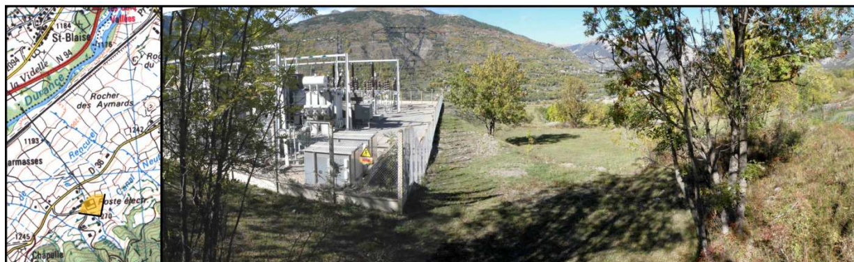
Vue du poste de Briançon (Villard-Saint-Pancrace)
